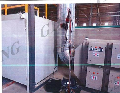
脱锡机废气排放口 DA014 处理前
