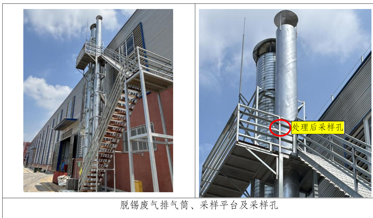
图4.2-2 脱锡机及废气治理设施现场照片
