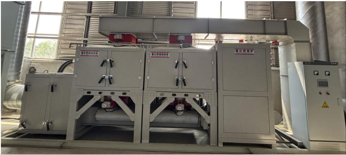
干式过滤箱+催化燃烧炉
