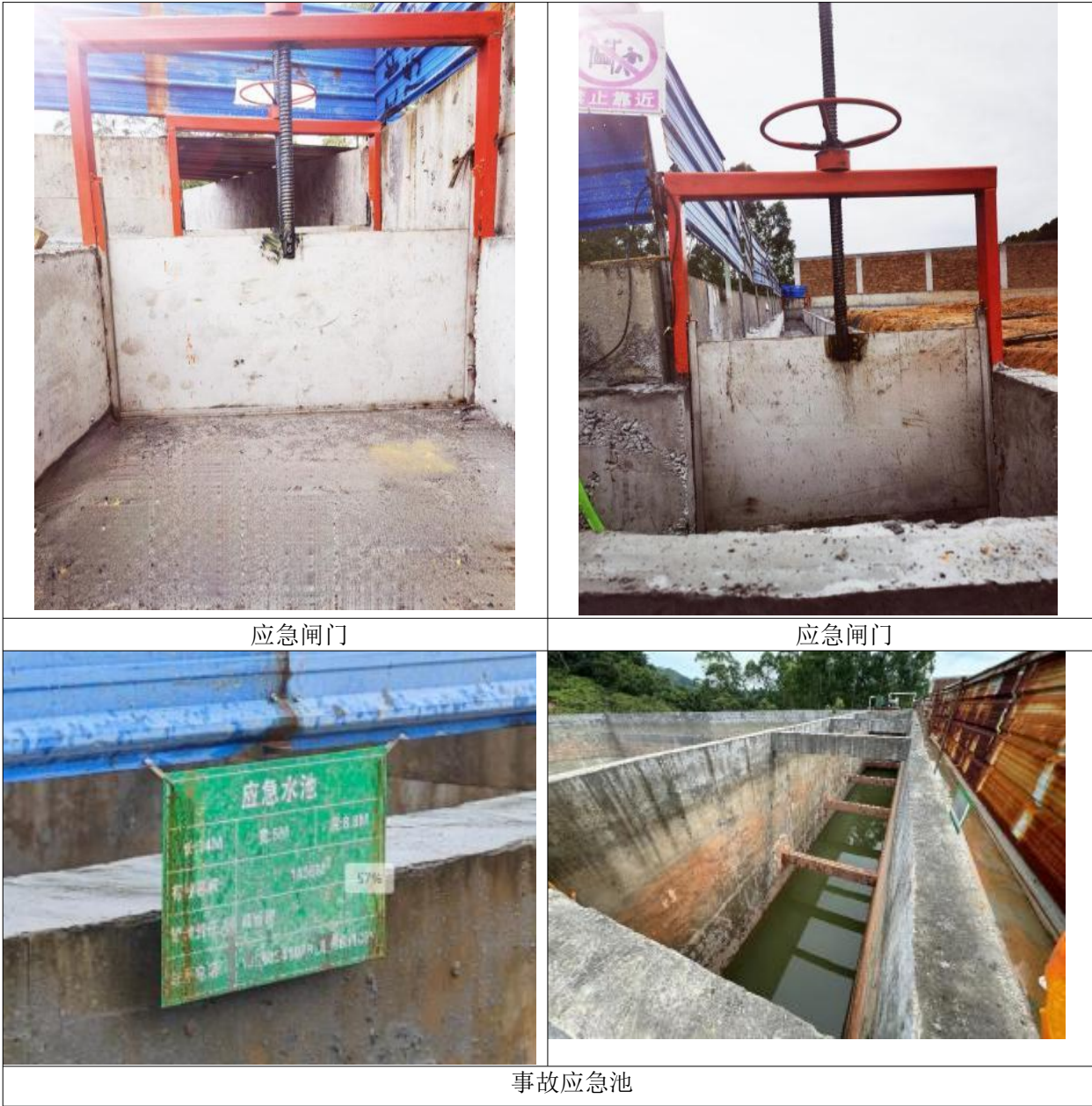
图4.3-1 公司应急防控措施现场照片
