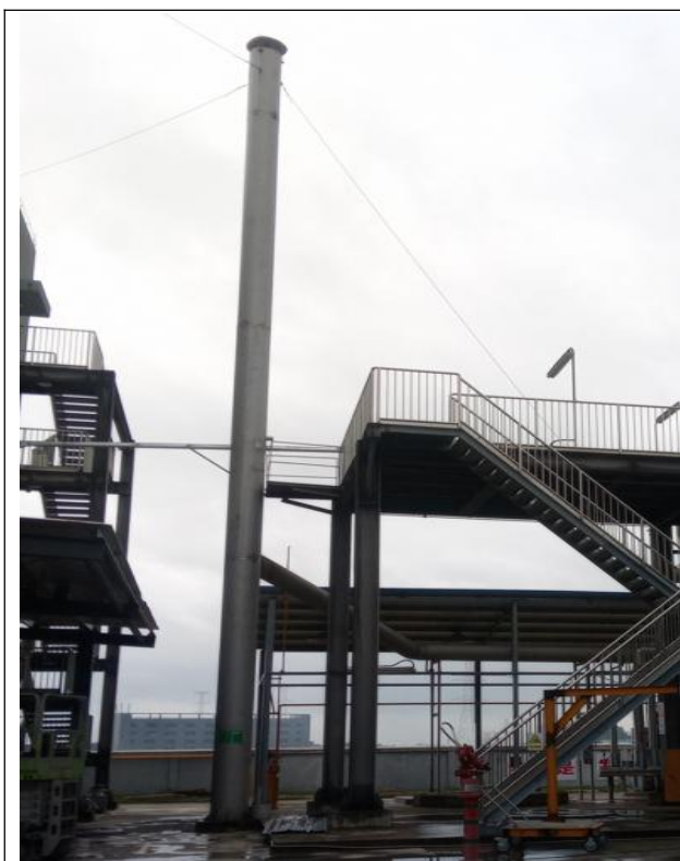
锅炉废气排放口
