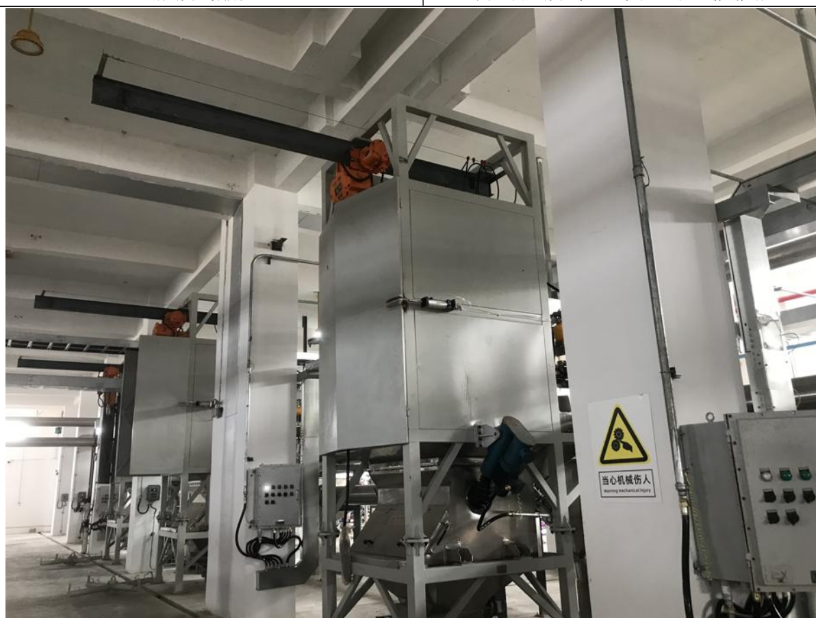
投料粉尘废气处理设施（布袋除尘）
