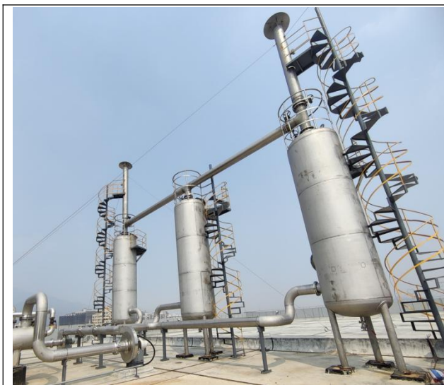
酚醛树脂、脲醛树脂废气处理设施（活性炭吸附）
