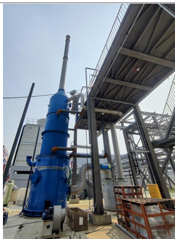
甲醛装置废气处理设施（尾气焚烧炉）
