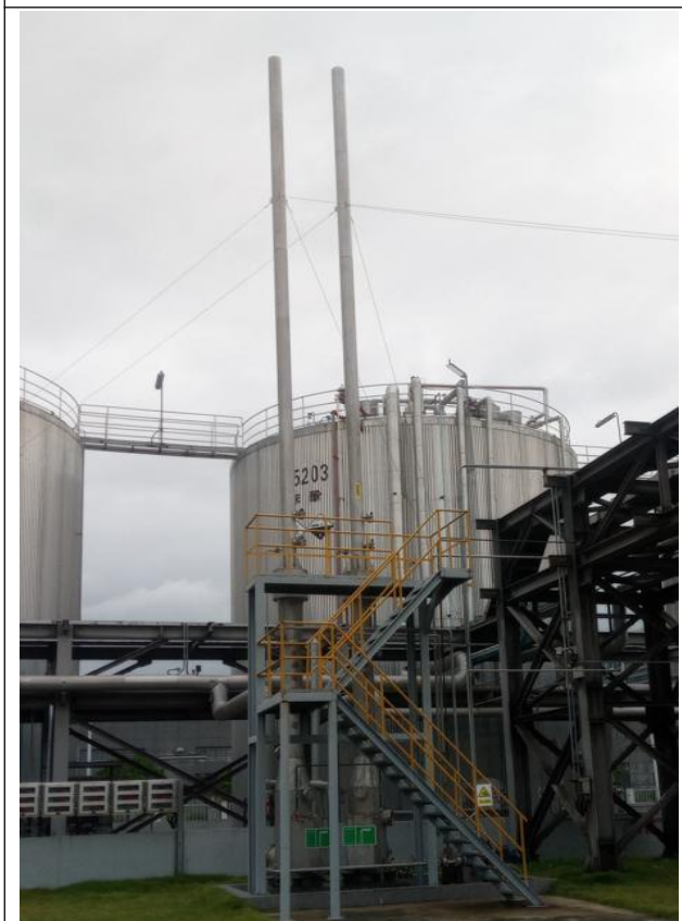
苯酚、甲醇储罐废气治理设施（一级洗气塔）
