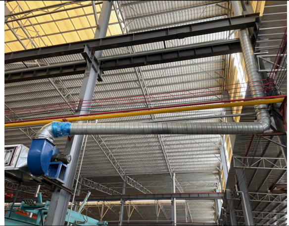
油雾废气排气筒
