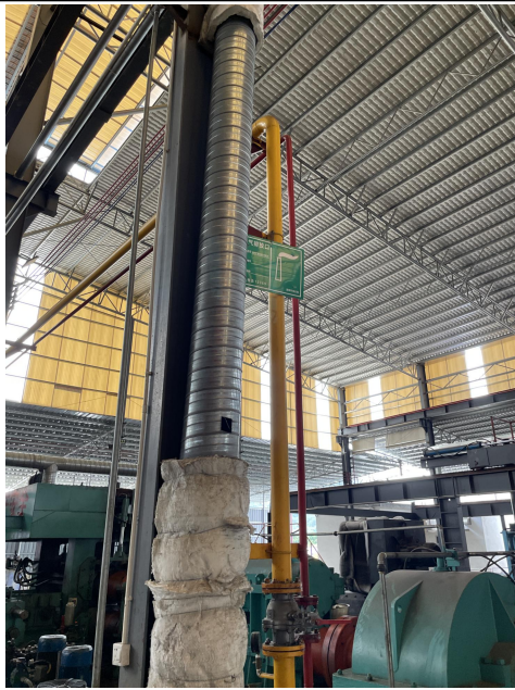
均质炉废气排气筒
