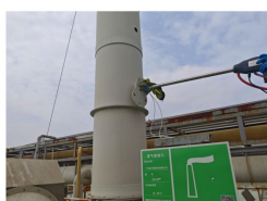
污水处理站废气排放口 (DA068)
