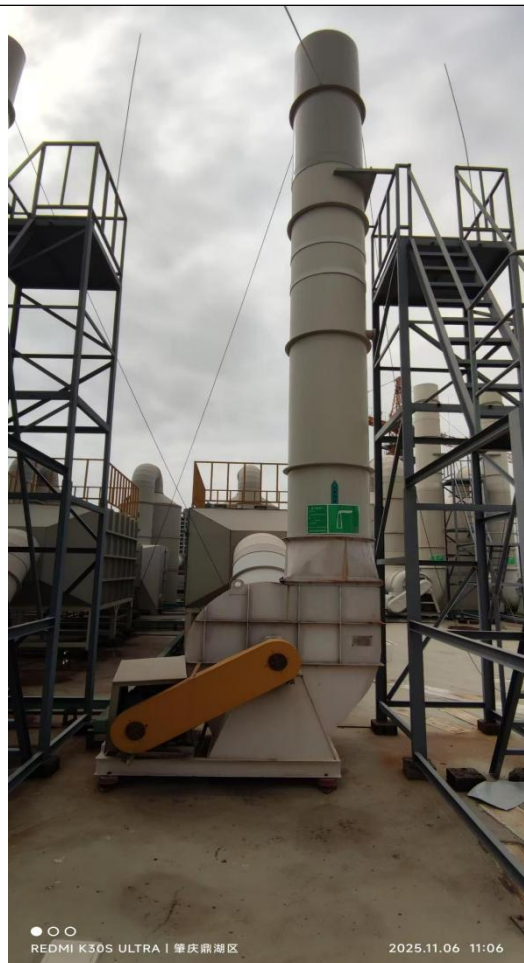
废气治理设施及标识 DA021
