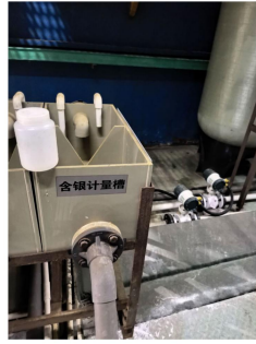
含银废水收集池
