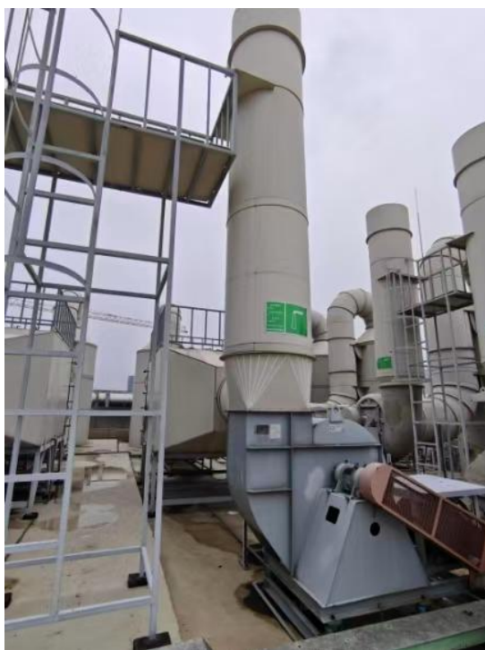
废气治理设施及标识 DA070
