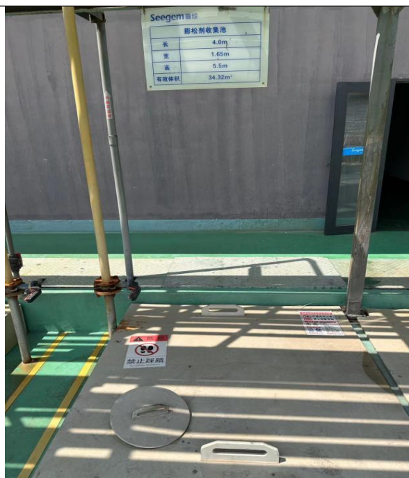
膨松剂收集池
