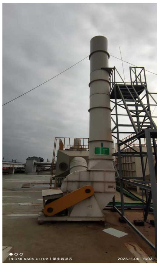
废气治理设施及标识 DA026
