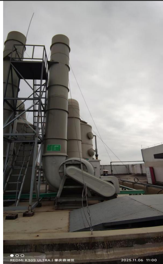
废气治理设施及标识 DA011
