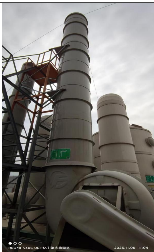
废气治理设施及标识 DA001
