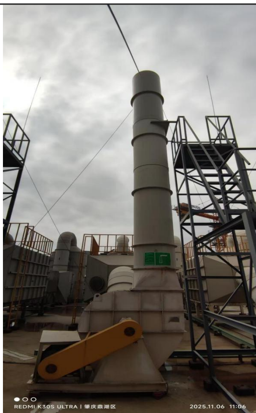
废气治理设施及标识 DA023
