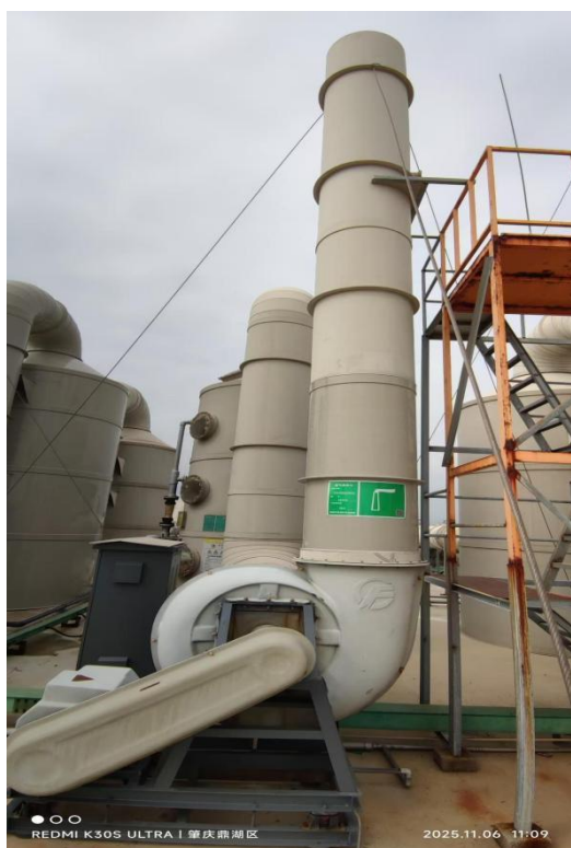
废气治理设施及标识 DA003
