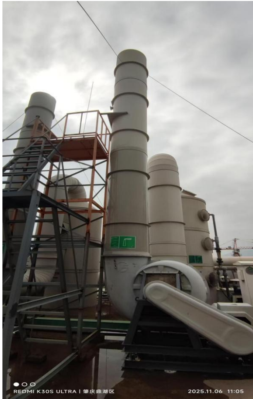
废气治理设施及标识 DA005
