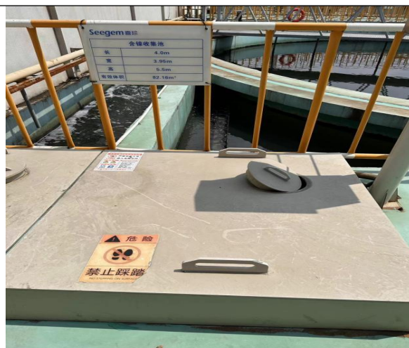
含镍废水收集池
