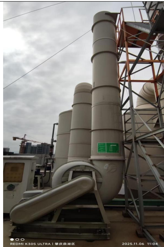
废气治理设施及标识 DA015
