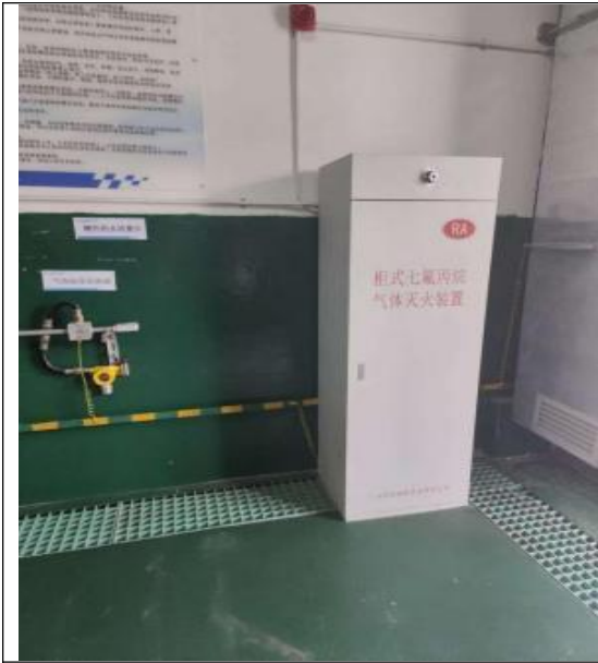
防泄漏槽、气体浓度检测器及灭火装置
