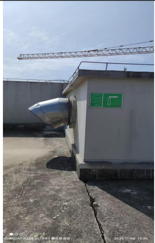
废气治理设施及标识 DA028
