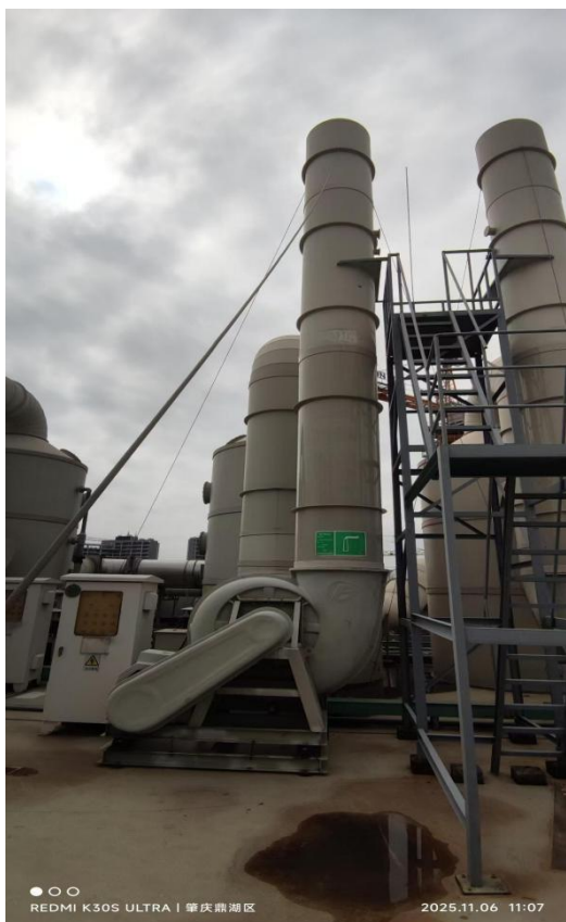
废气治理设施及标识 DA019
