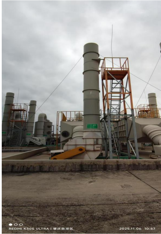
废气治理设施及标识 DA027
