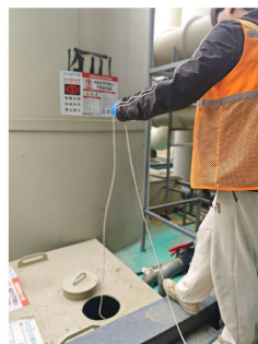
含银废水收集池
