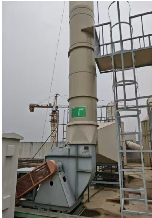
废气治理设施及标识 DA017
