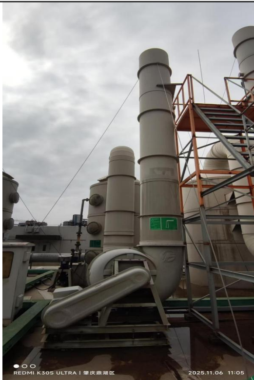
废气治理设施及标识 DA016
