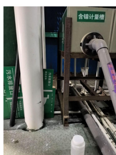
含镍废水排放口 (DW002)
