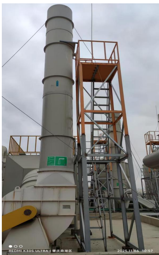
废气治理设施及标识 DA025
