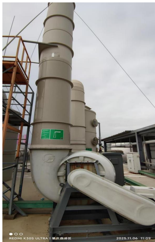
废气治理设施及标识 DA002
