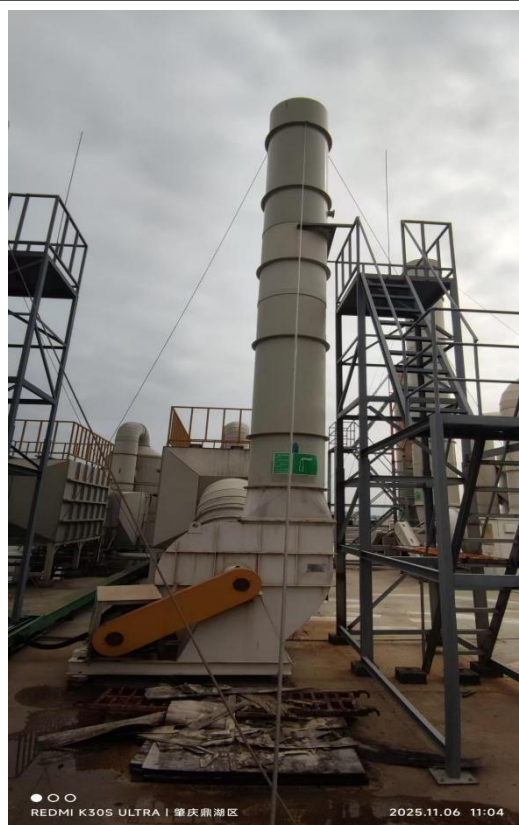
废气治理设施及标识 DA024
