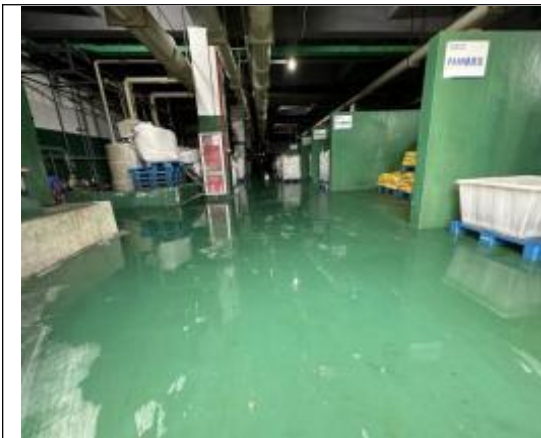
综合事故应急池
