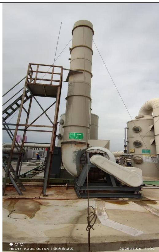
废气治理设施及标识 DA004
