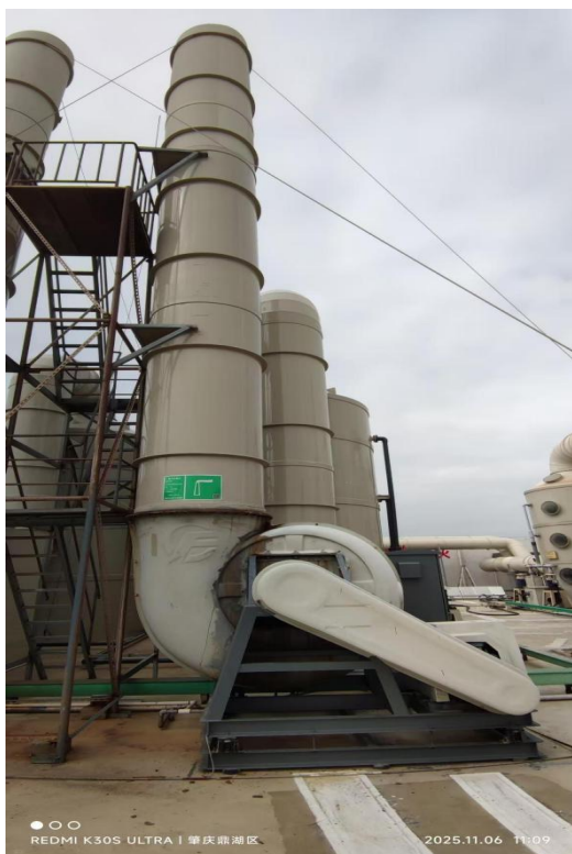
废气治理设施及标识 DA013
