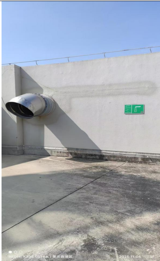
废气治理设施及标识 DA029
