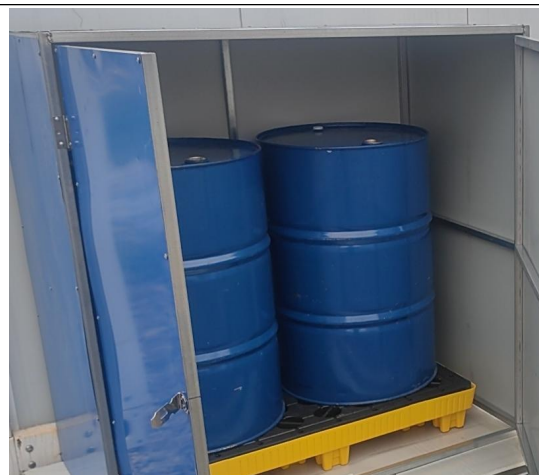
危废间内废变压器油暂存桶及防渗托盘
