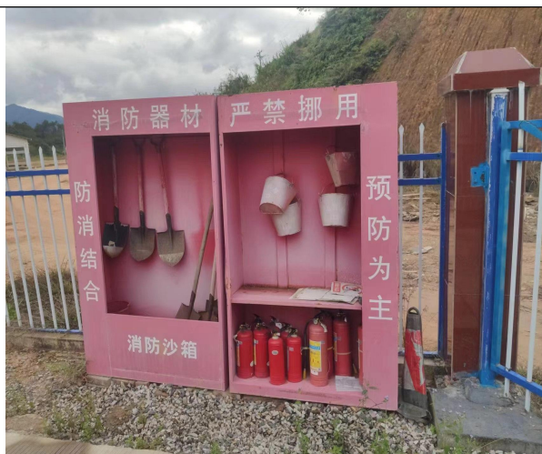
开关站内 应急物资柜
