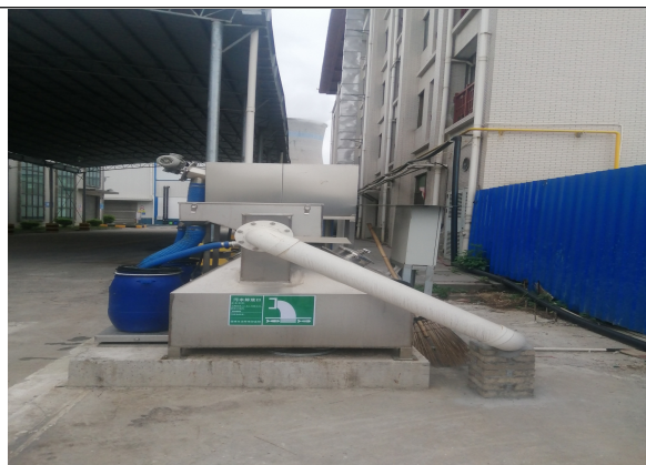
DW002 污水排放口
