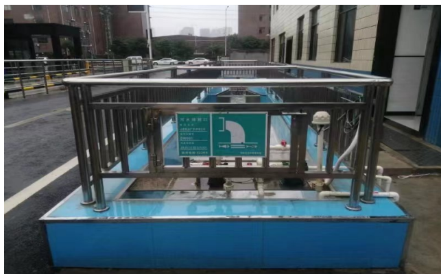
DW001 废水排放口
