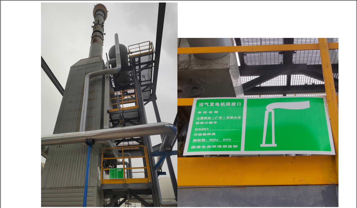
DA001 沼气发电机废气排放口
