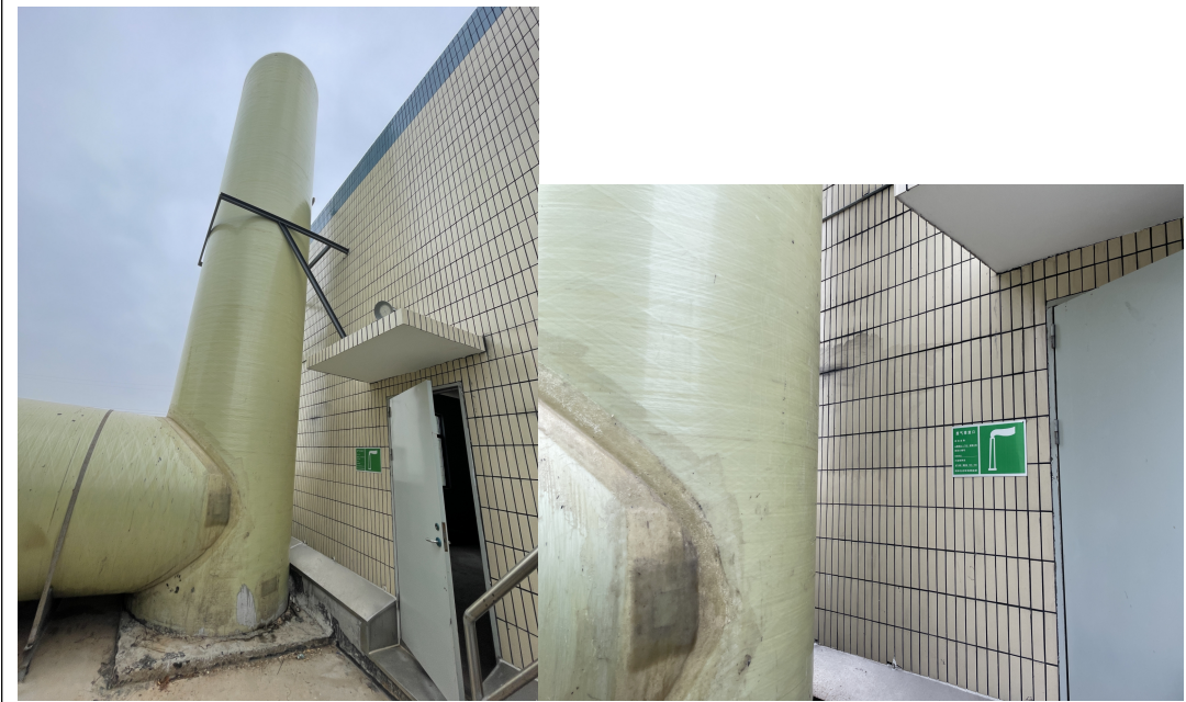
DA002 废气排放口
