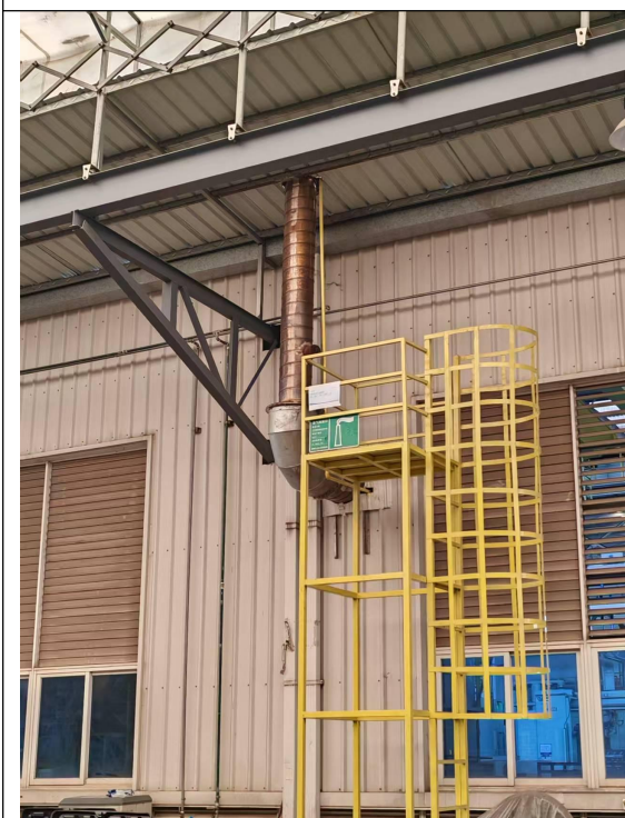
DA004 废气排放口
