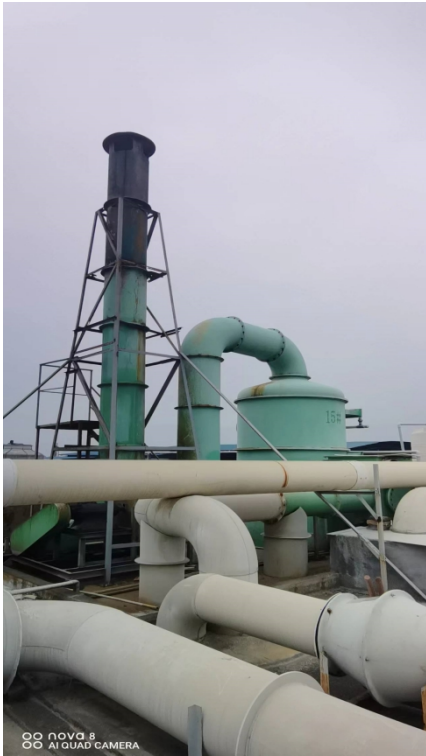
95-96 号生产线废气排放口 DA016
