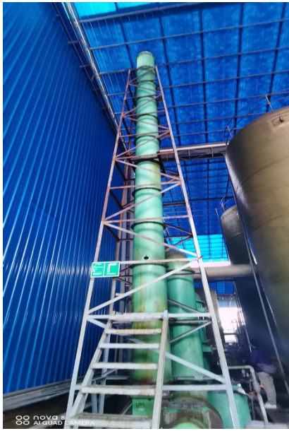
二期原料间（储罐区）排放口 DA021
