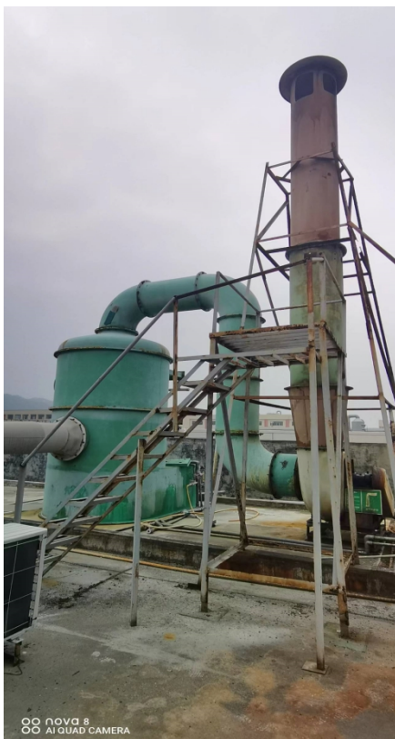
91-92 号生产线废气排放口 DA018
