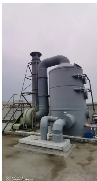
65 号生产线废气排放口 DA014
