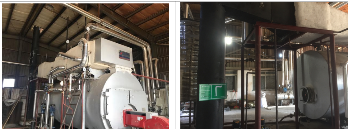
锅炉废气排放口 DA003
