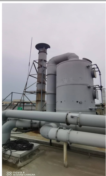
66 号生产线废气排放口 DA013
