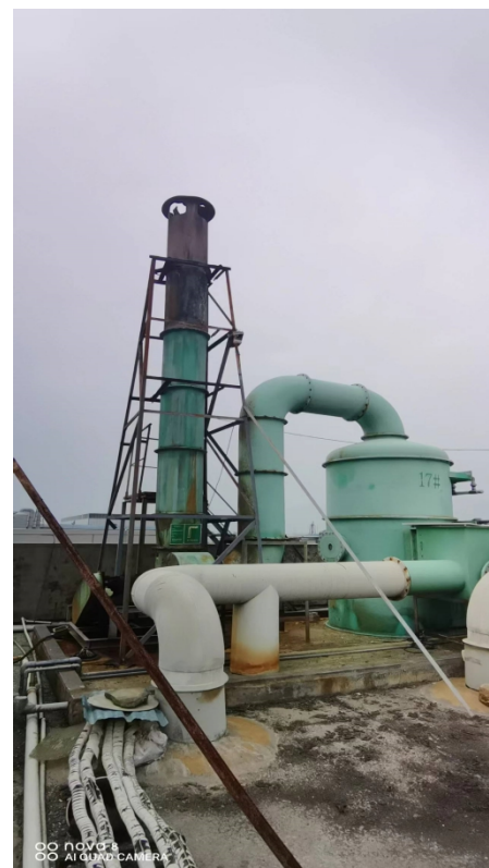
二期车间废气排放口（车间抽风）DA020
