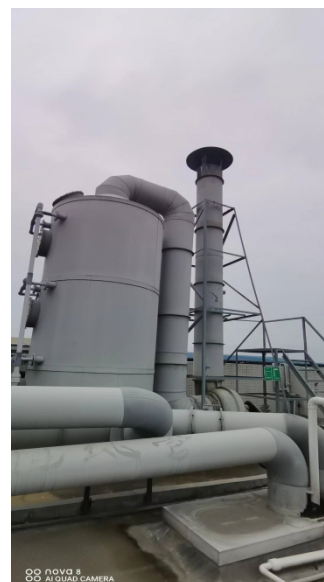
64 号生产线废气排放口 DA015
