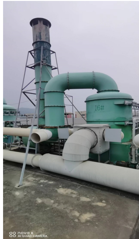
93-94 号生产线废气排放口 DA017
