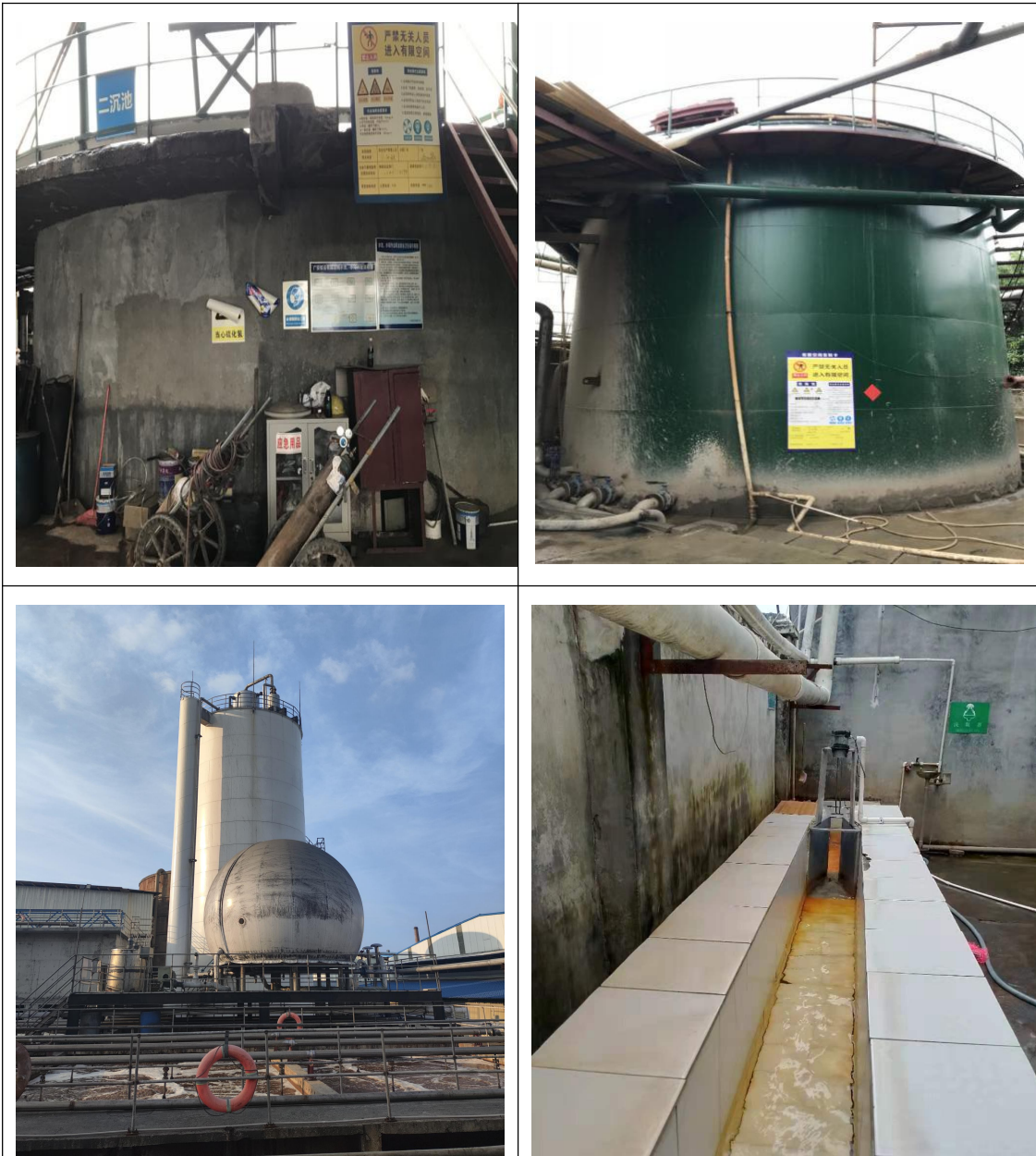
污水处理设施及废水排放口
