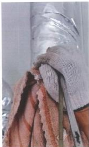
备用发电机燃油废气排放口7#
