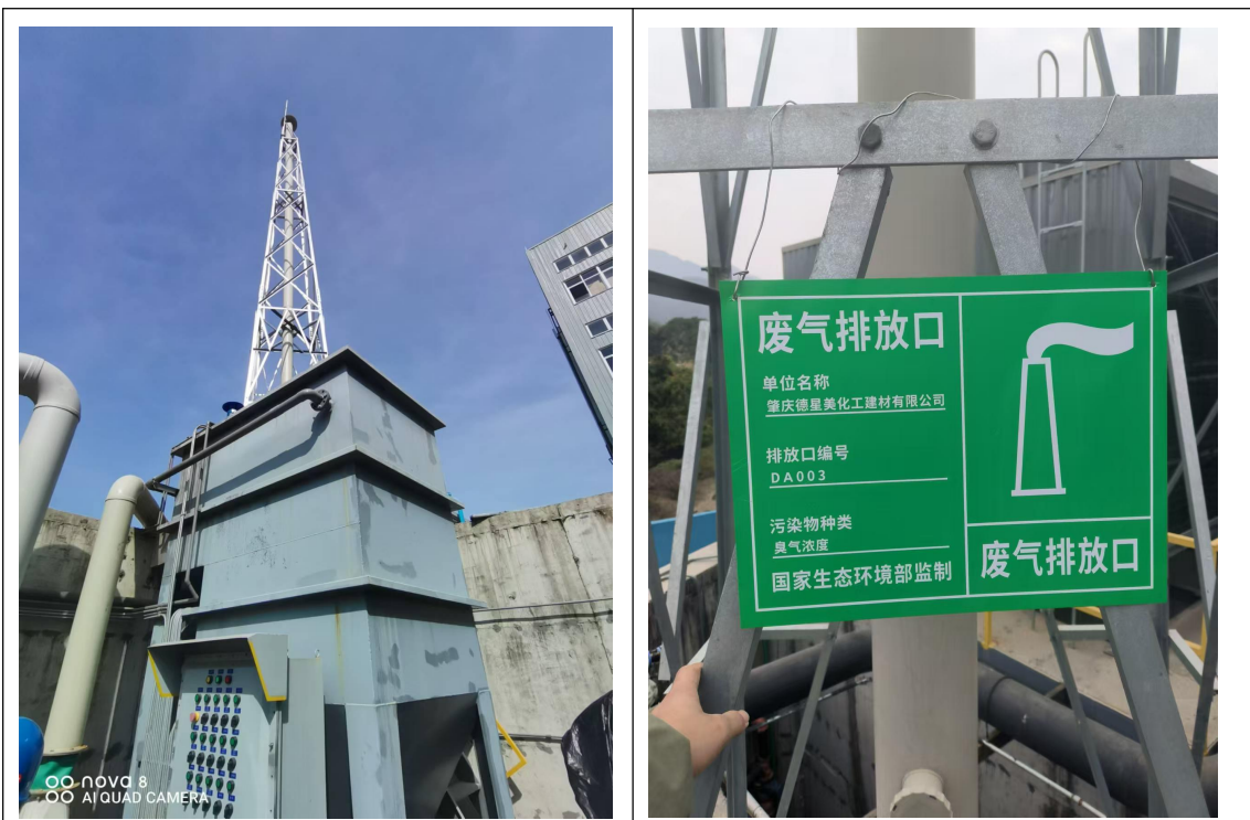
污水处理站废气排气筒
