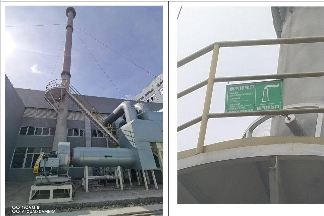
焚烧废气排气筒
