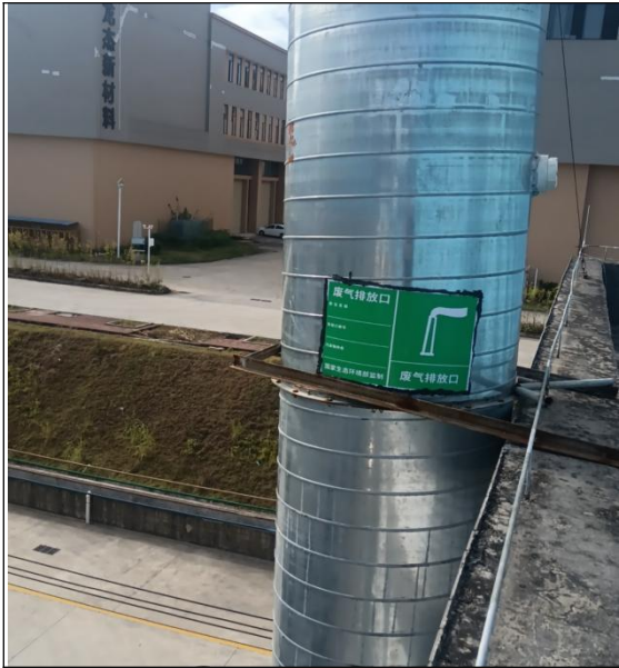
DA003 废气排放口
