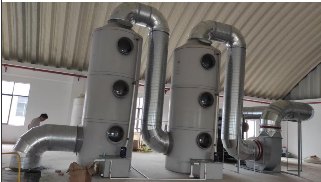
二楼二级喷淋塔（处理车间异味，DA003）
