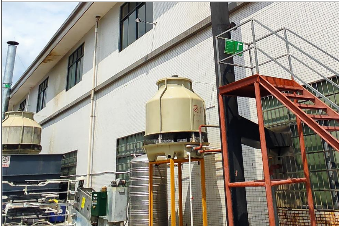
DA001 和 DA002 废气排放口
