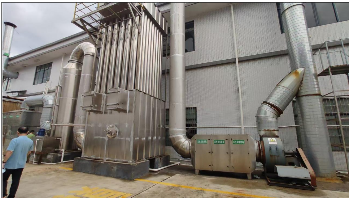
“二级喷淋塔+静电油烟净化器+活性炭吸附”装置（DA001）
