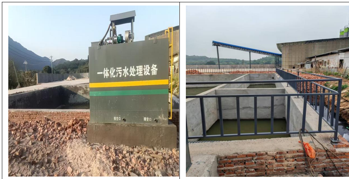
图 4.1-2 生活污水处理设施图
