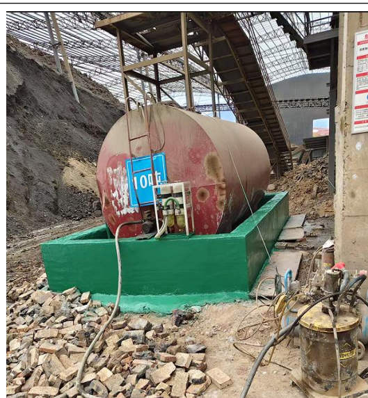
柴油储罐围堰
