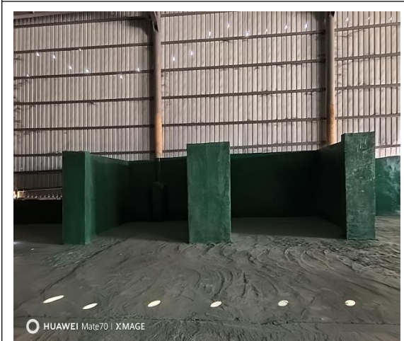
废吨袋暂存点防渗防漏措施
