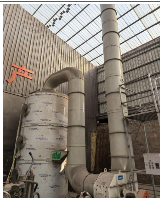
DA004 铝灰拆筛废气排放口
