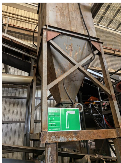
DA006 陶粒生产线粉尘排放口
