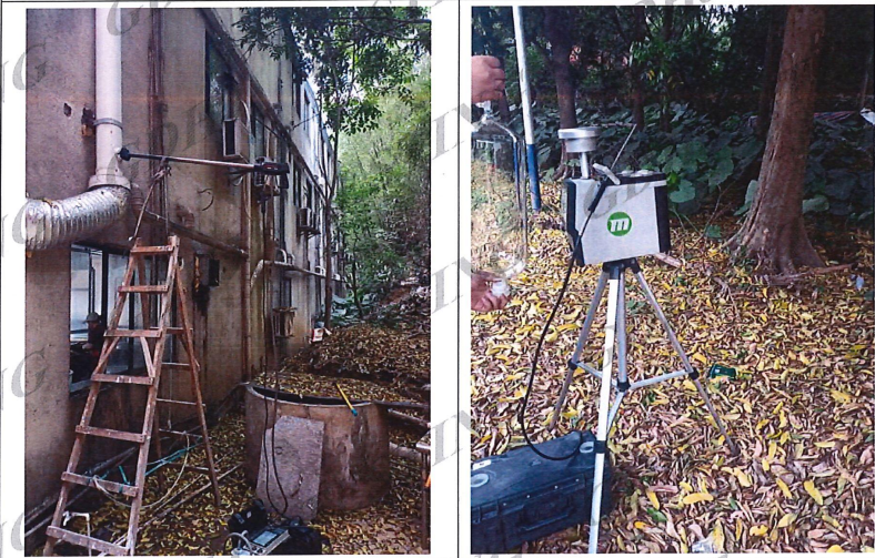
厨房油烟排放口处理后
