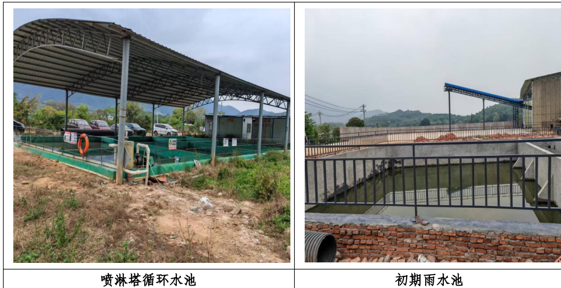
图 4.1-4 废水设施现场图
