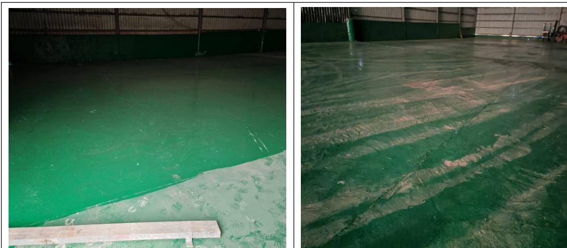
铝灰仓防渗防漏措施
