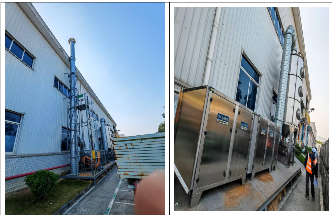
DA003 废气排放口
