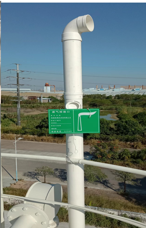
粉料进筒仓废气排气筒
