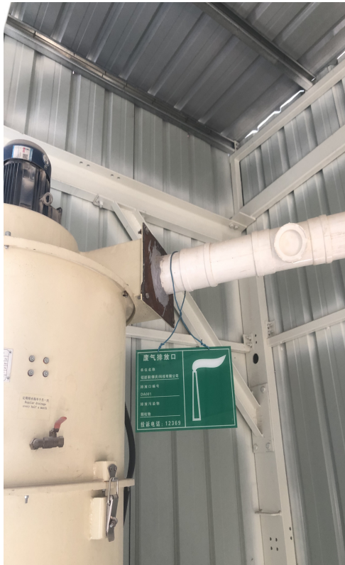
配料搅拌废气排气筒
