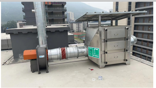
实验废气处理设施
