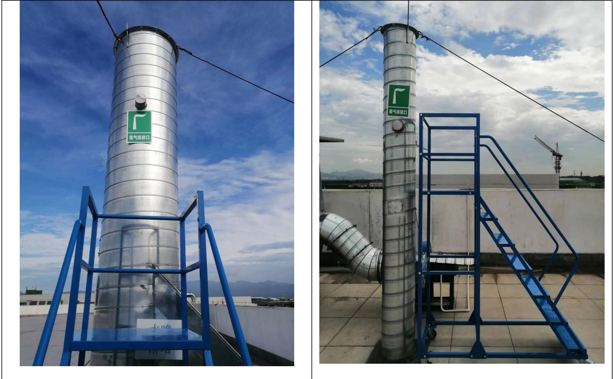
排气筒采样口、监测平台及标识牌
