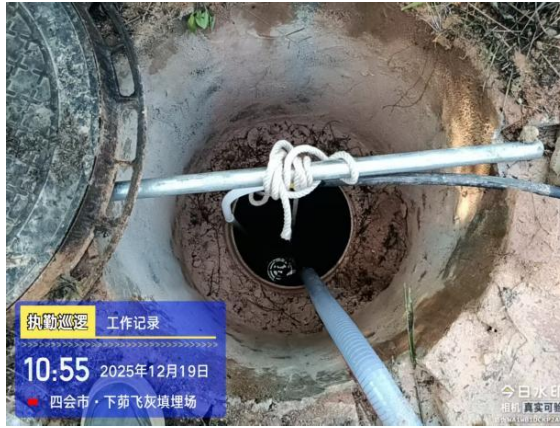
洗车废水收集井（及水泵）
