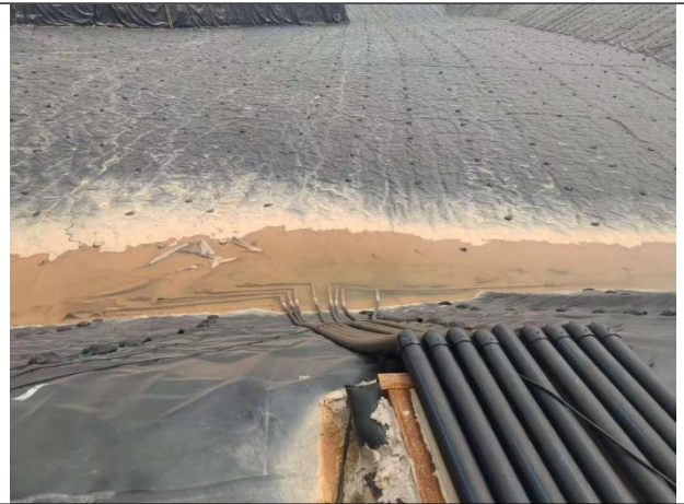
雨水抽拍管网
