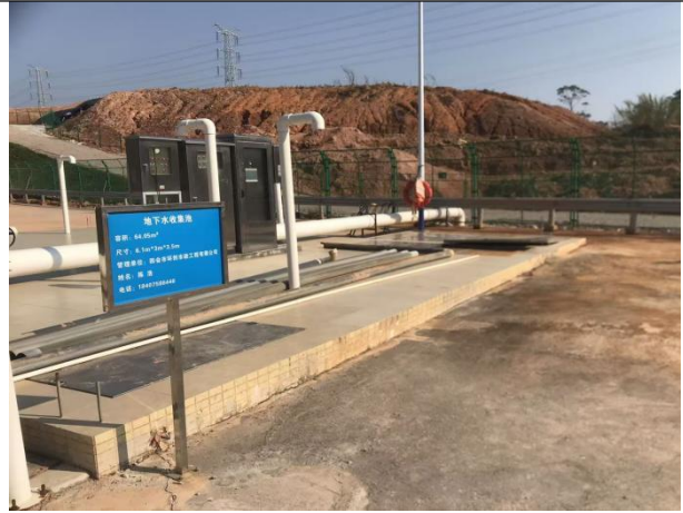
地下水监测井（排水井、地下水收集池）
