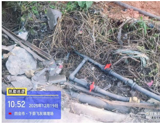
淋溶液输送管道及开关
