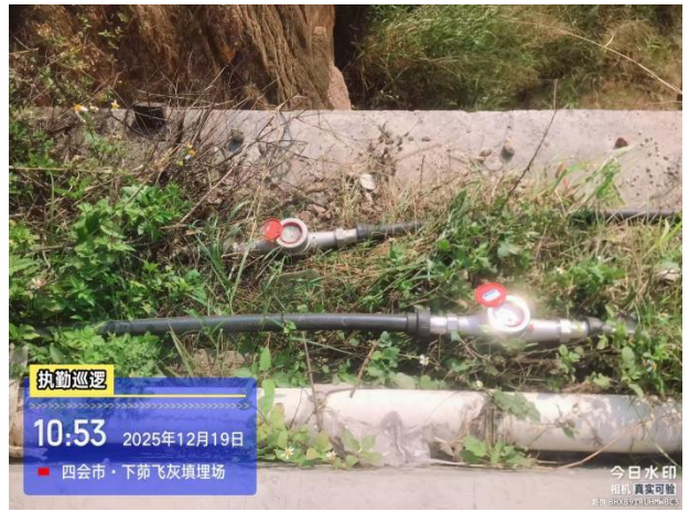
淋溶液输送管道及水表
