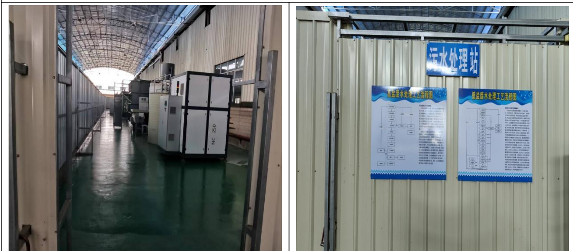
废水处理设施
