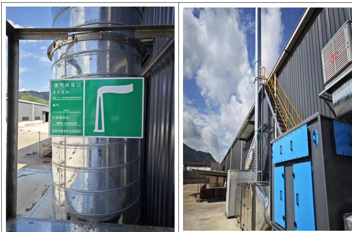
DA001废气排放口
