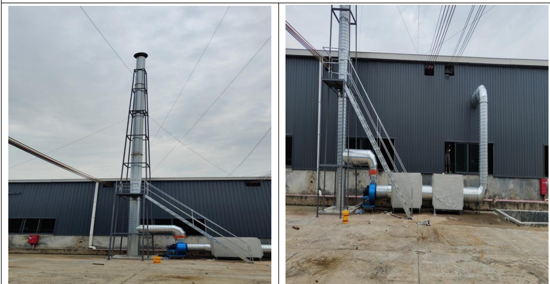
废树脂粉综合利用线有机废气排放口DA007
