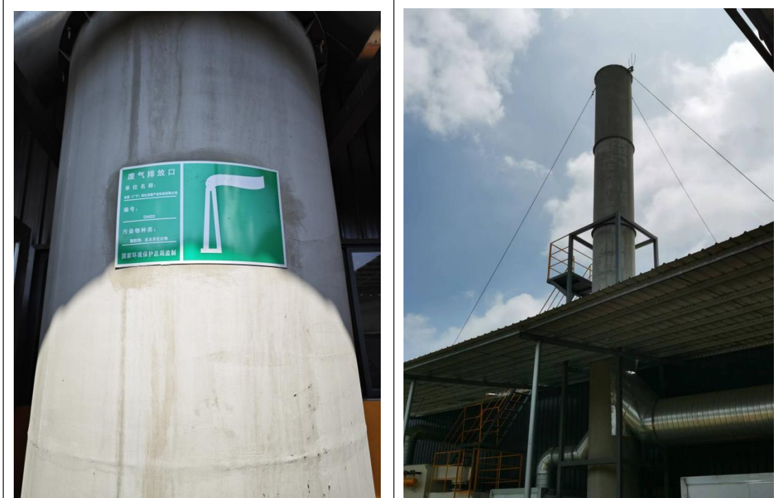
DA003废气排放口
