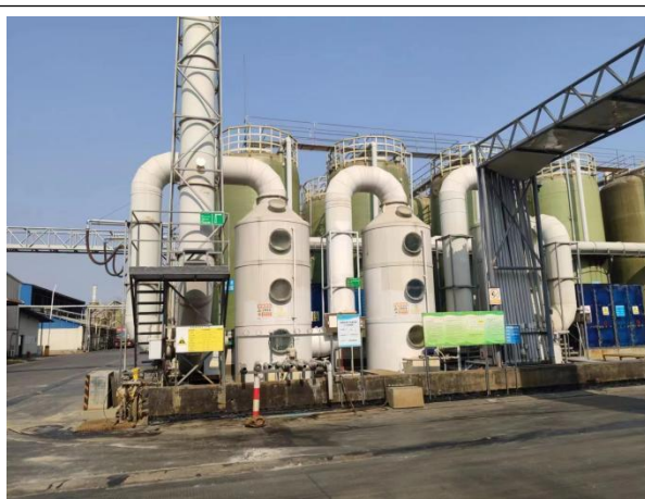
储罐区废气处理设施及排放口DA001
