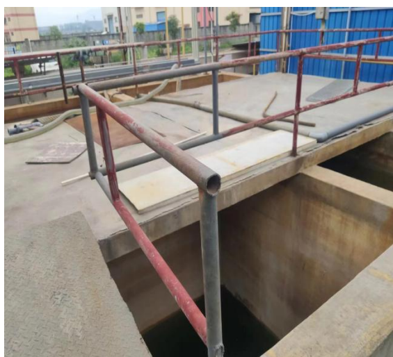
雨水收集池1个180m 3 （储罐区2#旁）
