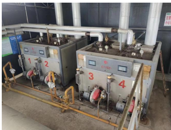
新增4台0.5t/h燃天然气蒸汽发生器 (生产车间楼顶)
