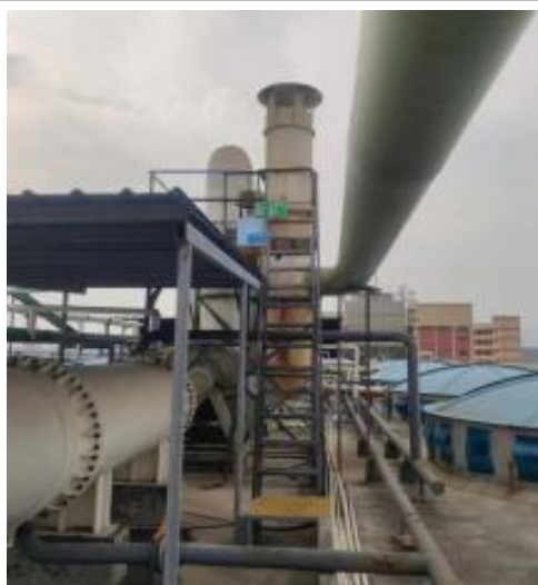
生产车间废气处理设施及排放口DA002
