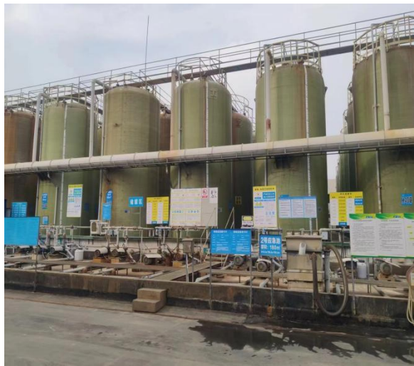
储罐区1#新增储罐18个（技改后共80个）
