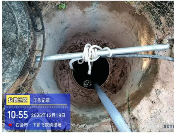
洗车废水收集井（及水泵）
