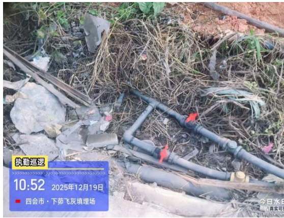
淋溶液输送管道及开关
