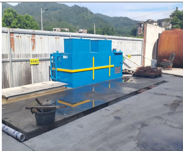
一体化生活污水处理设施
